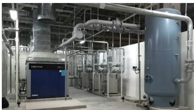
Hệ thống máy nén khí
