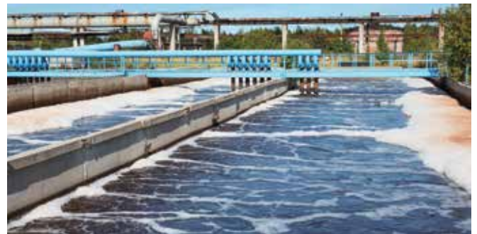
Hệ thống xử lý nước
