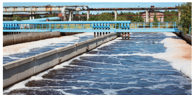
Hệ thống xử lý nước
