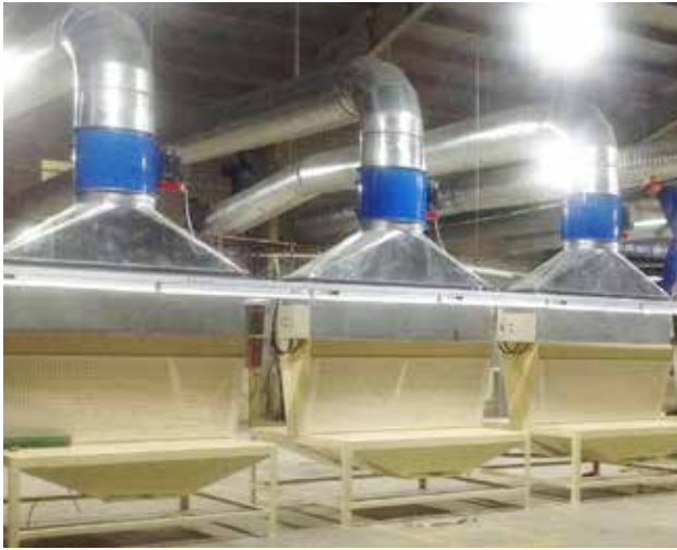
Điều khiển hệ thống quạt hút bụi sử dụng biến tần GD200A
