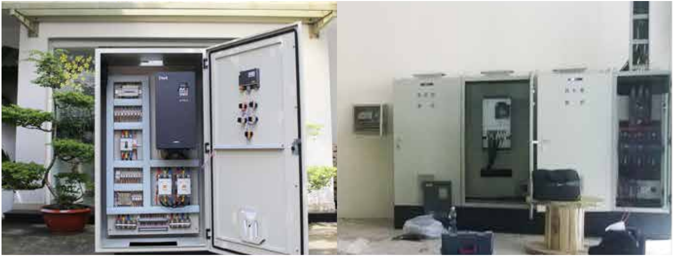
Dự án lắp biến tần 10 máy nén khí công suất 37 - 110kW Công ty TNHH Ấc Quy GS Việt Nam
