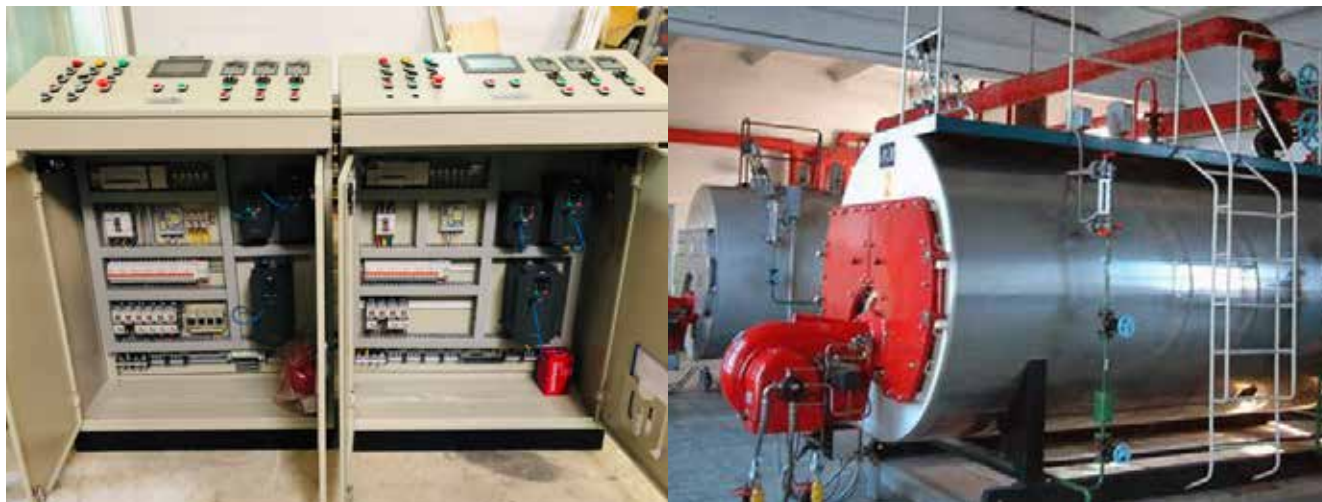
Tủ điều khiển lò hơi/lò đốt sử dụng biến tần GD200A - Công ty TMSX Lò Hơi Tầng Sỏi 3E - Công ty Hùng Xin
